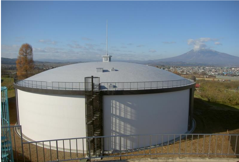
原ヶ平配水池
