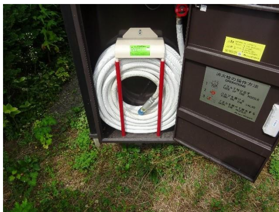
[易操作性屋外消火栓 (旧弘前藩諸士住宅 (旧笹森家住宅))]
