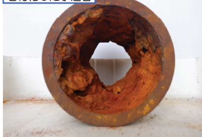
老朽化した水道管
