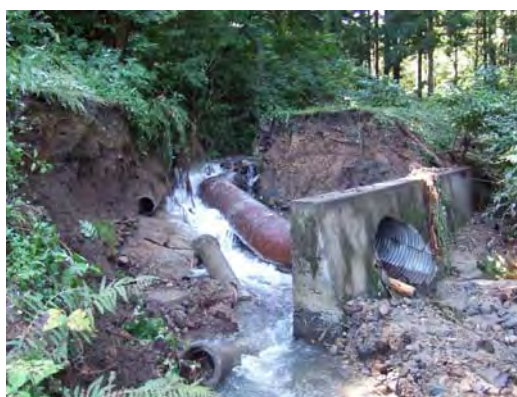
赤沢取水口道路崩落決壊状況
