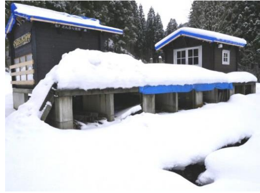
1月20日雪割板による落雪状況（北側）
