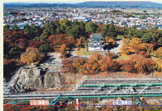
（※1）令和5年10月末時点の石垣積直し状況
