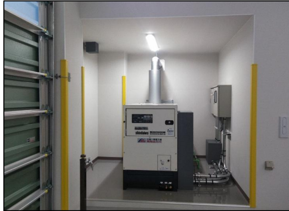
・完成（発電機）
