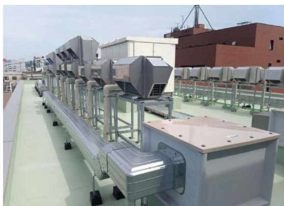
完成（空調室外機）
