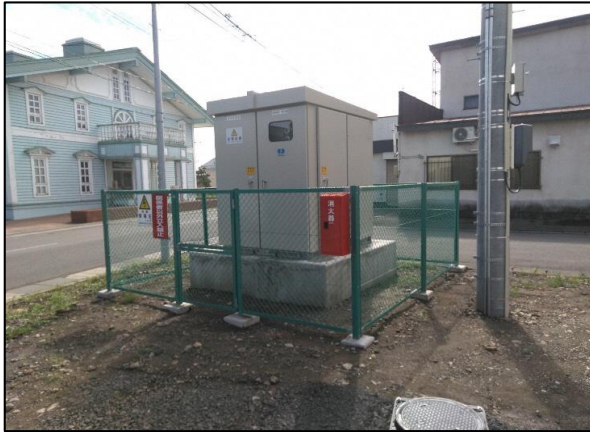
・完成（キュービクル）
